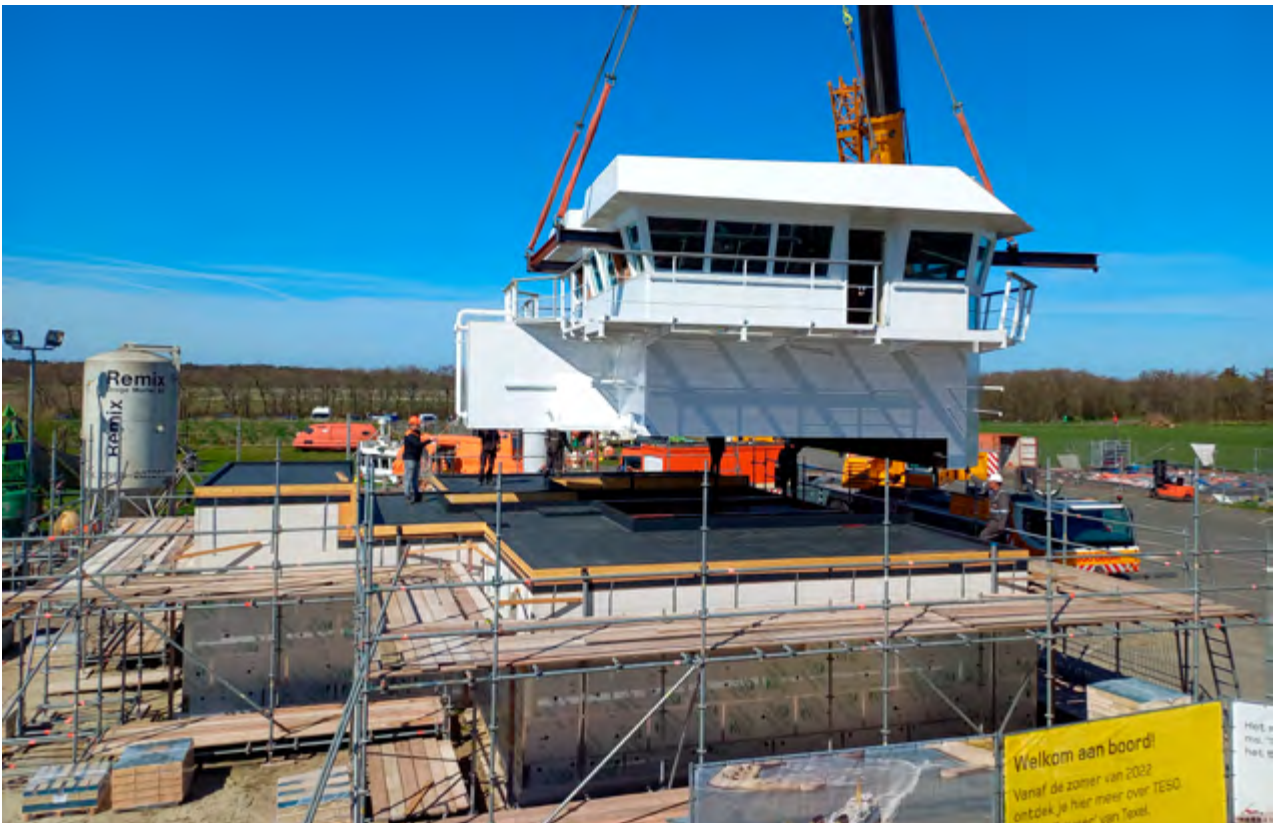
Maart 2022: de brug van ms. 'Schulpengat' wordt geplaatst op de definitieve locatie bij het Maritiem- en Juttersmuseum Flora.
